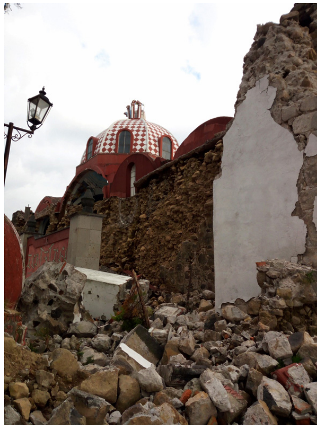
Daños exteriores en la parroquia de San Pedro y San Pablo, Ecatzingo.
