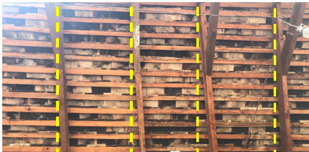
Imagen 3. Fotografía del desplazamiento de la cubierta causado por el movimiento telúrico del 19 de septiembre de 2017 "Capilla de San Agustín", ubicada en el municipio de Tetela del Volcán, Estado de Morelos, Fotografía: CAV Diseño e Ingeniería S.A. de C.V.
