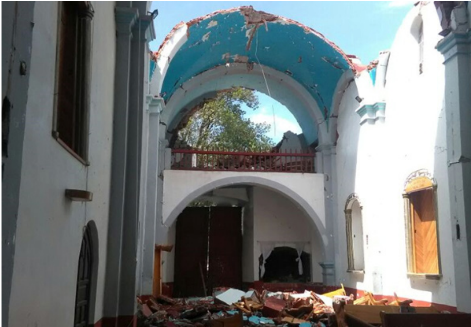
.Daños interiores en Parroquia de San Pedro y San Pablo Ecatzingo.
