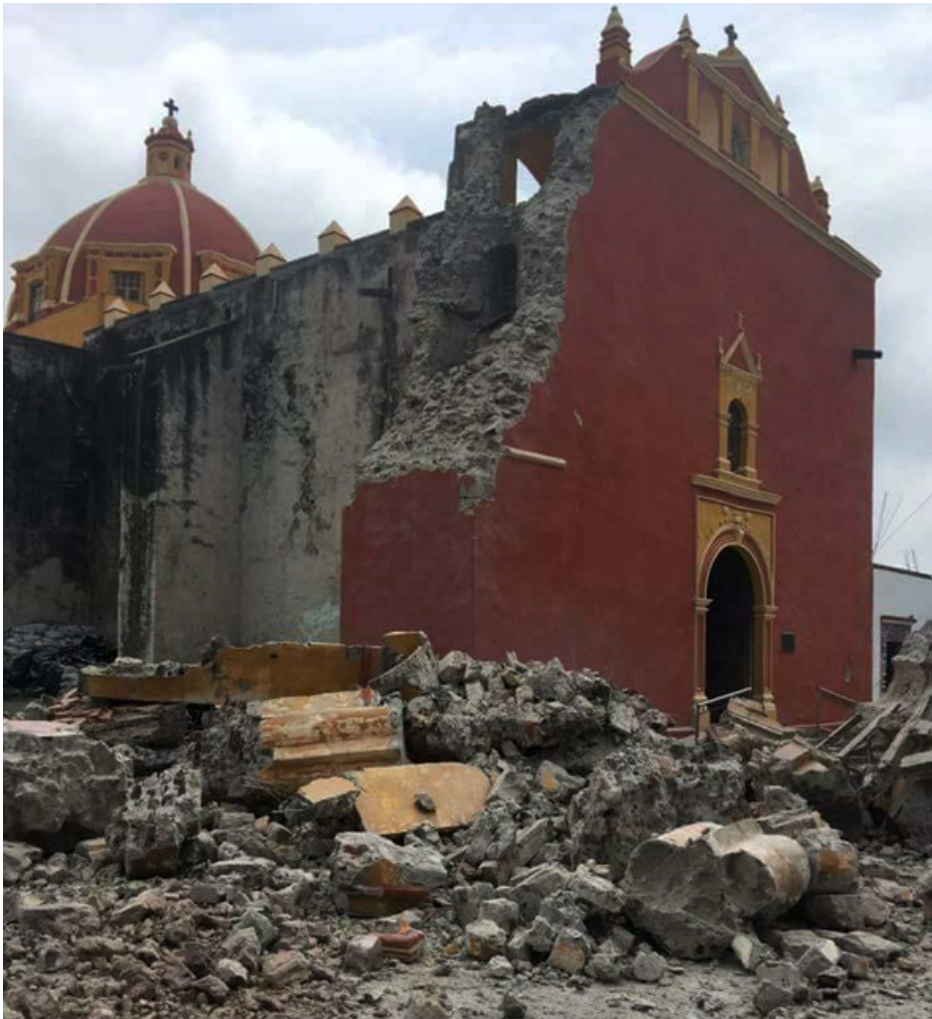
Daños en la parroquia de San Esteban Protomártir, Tepetlixpa.
