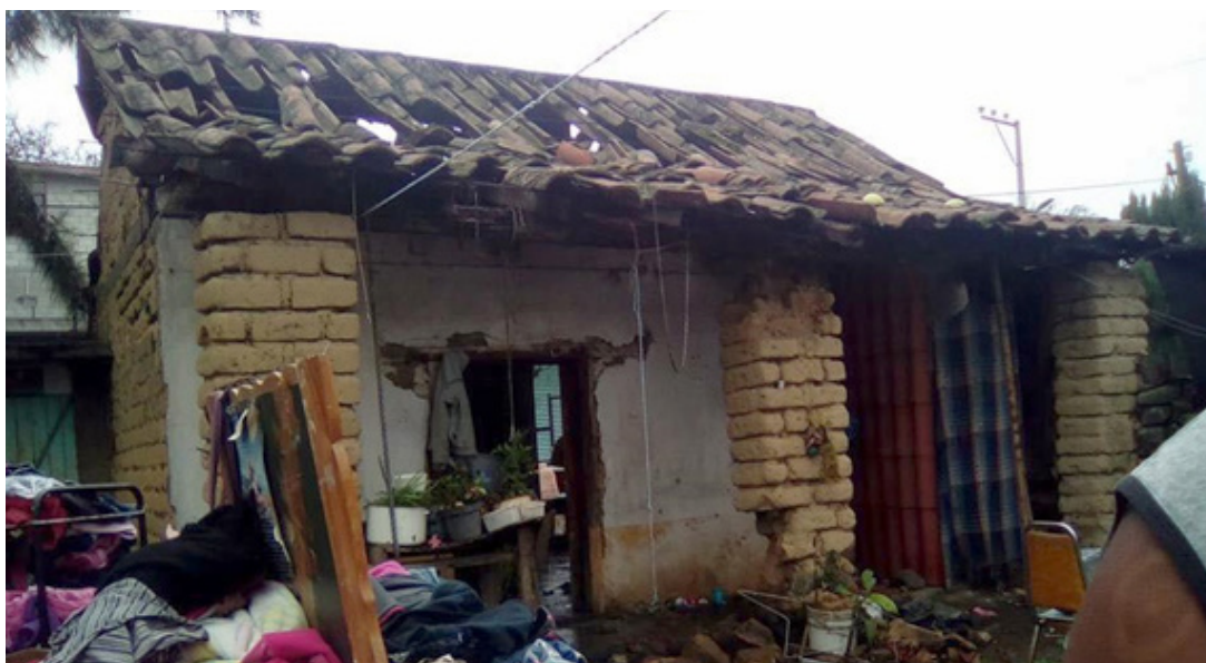
Daños en viviendas del Estado de México.
