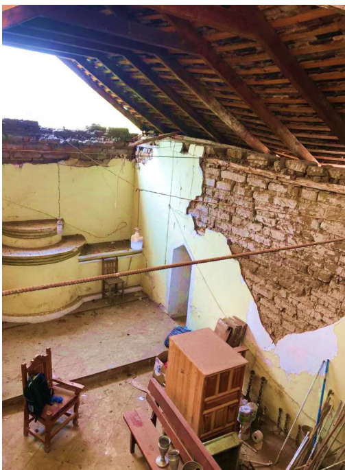
Imagen 4. Daños en cubierta de madera, muros laterales y muro testero, "Capilla de San Agustín" ubicada en el municipio de Tetela del Volcán, Estado de Morelos. Foto: CAV Diseño e Ingeniería S.A. de C.V.
